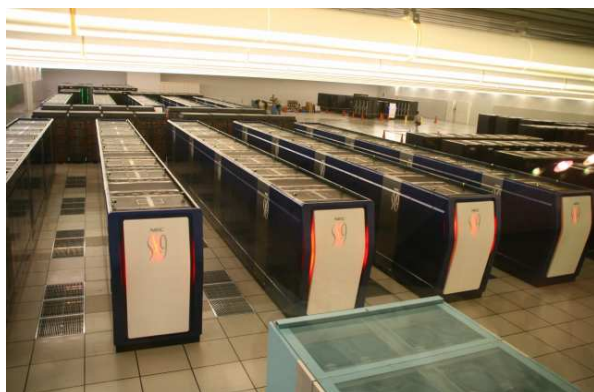
稼働中のスーパーコンピューター NEC製「SX-9」
